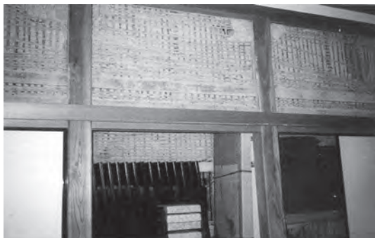
図表30 宝満寺壁の損傷・神戸市長田区 (小壁の土部の剥落)
