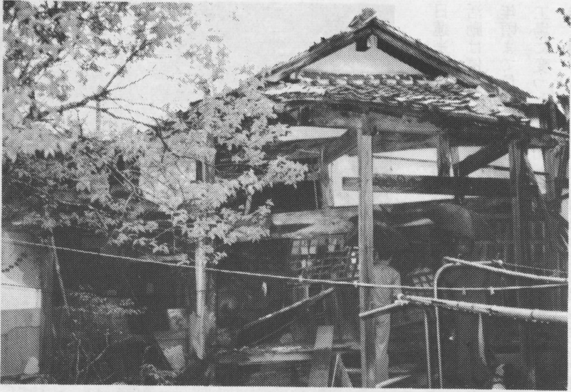
崩壊した某寺
