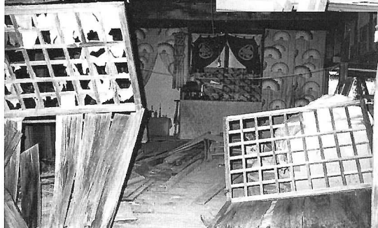
荒廃した本堂の状況
