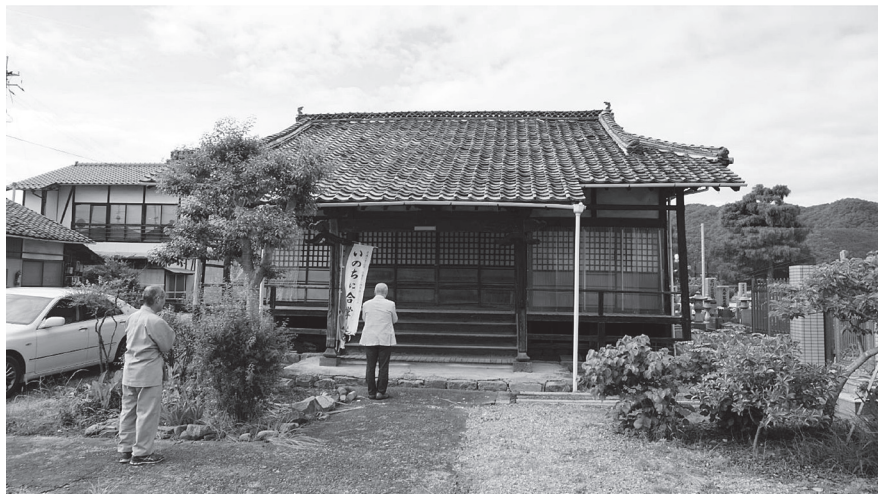
写真3 庫裏は撤去され、本堂は屋根や外壁の損傷が進む寺院（2018年広島備北調査より）
